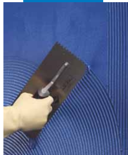
Întinderea de Kerapoxy Design albastru utilizat ca adeziv cu o spatulă dințată
